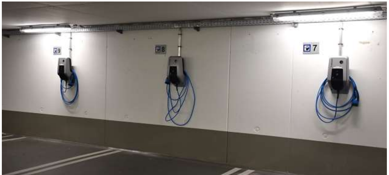
3 der 13 vorhandenen Ladestationen in der Tiefgarage des Gästehauses 4
